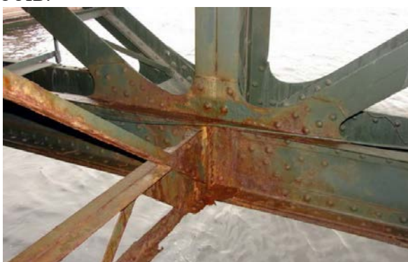
Рисунок – 1. Корозія елемента мостової конструкції
